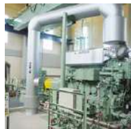
ポンプ場内2階。この下にポンプがある。
