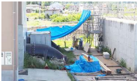
場外。上の写真で搬入した吐出配管が設置された箇所(右図④)。
