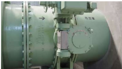
場内。株式会社クボタ様のポンプと連結している箇所(右図⑤)。
