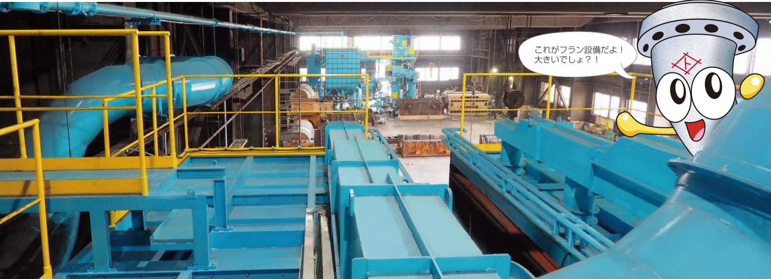
広大な作業場の両端に新設された設備。手前の設備で鑄込みの終わった砂を解体～再生して奥のミキサーへ圧送する。真ん中の作業スペースには大きな金枠がたくさん並び、ここで鑄込みもする。
