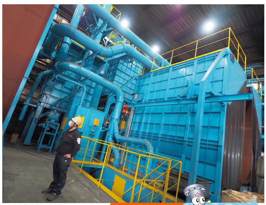
砂の解体(右半分)～再生(奥)をする設備。全体は高さ12m弱になる。最初の写真はこの設備の上部から見下ろした風景。
